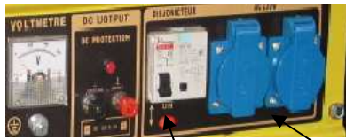
Disjoncteur Prise AC
